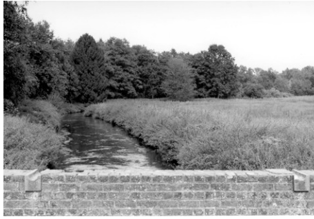
Rustbank op brugmuur
