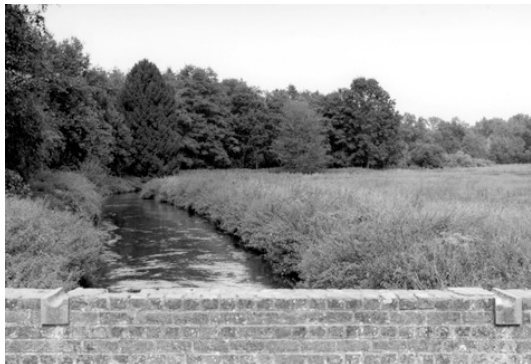
Rustbank op brugmuur
